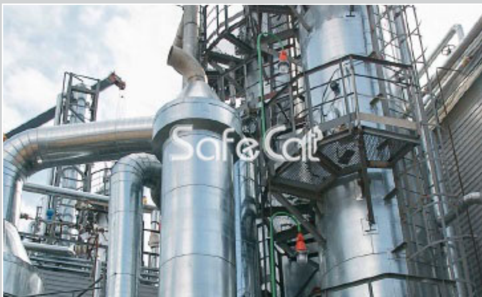
Система газоочистки ПГ «БТ» в составе установки по производству КФК и малометанольного 55 % формалина
